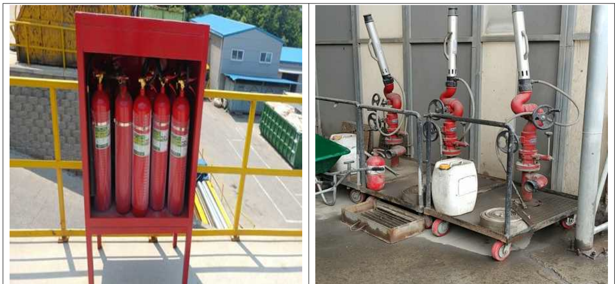
◆ 소각·매립업체 사업장 내 소화전 및 물대포 설치
